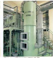
アルカリ活性炭触媒洗浄塔
