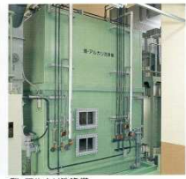
酸・アルカリ洗浄塔
