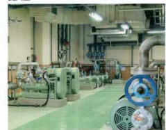
地下ポンプ室
