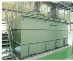
低濃度活性炭吸着塔
