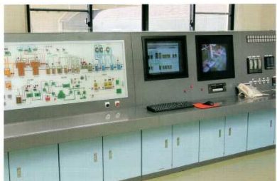
中央監視設備
